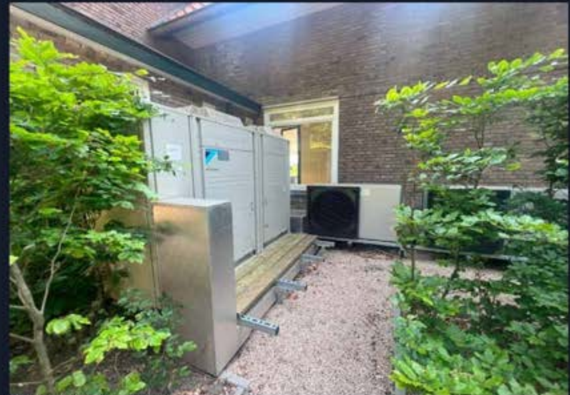
Overzicht airco buitenplaats opstelling
